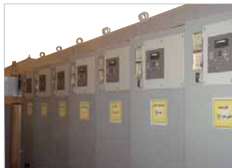
Relés SIL-A instalados en subestación eléctrica del Azadi Football Stadium
